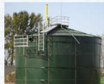
辽宁餐厨垃圾处理 500m 3 CSTR罐
