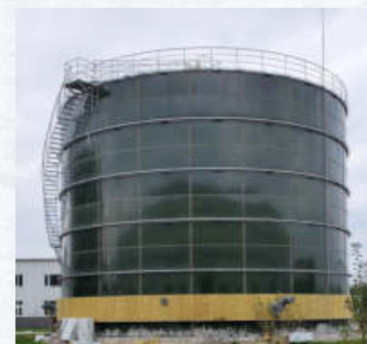
河北制药厂污水 1800m 3 UASB罐
