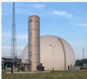
3000立方胶州小涧 西固体废弃物项目
