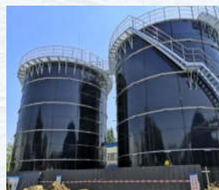
广东造纸厂污水处理 两套800m 3 UASB罐
