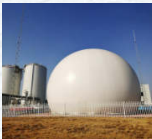
2000立方乳山大型 生物质天然气项目
